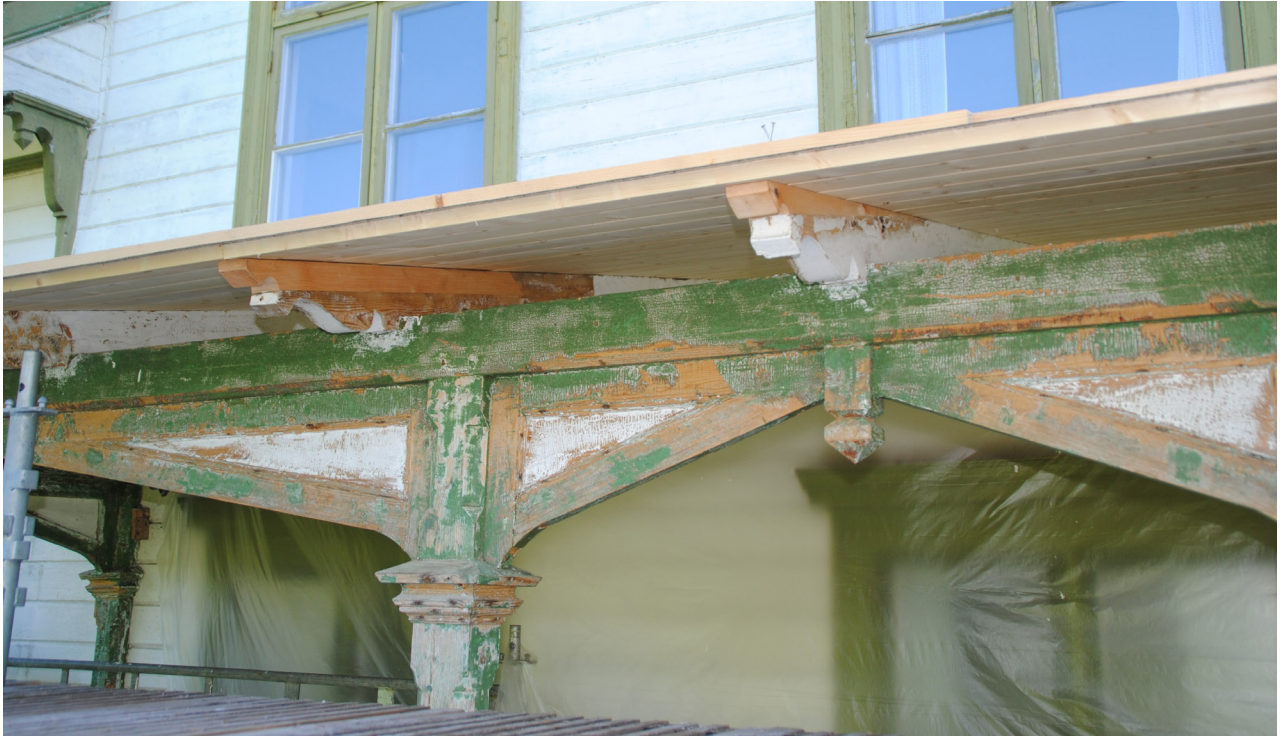
De två takbjälkar som hade mindre rötskador gick att laga i med nytt virke.
