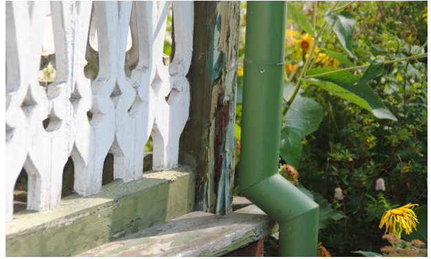
Den högra främre stolpen hade en stor rötskada nedtill.
