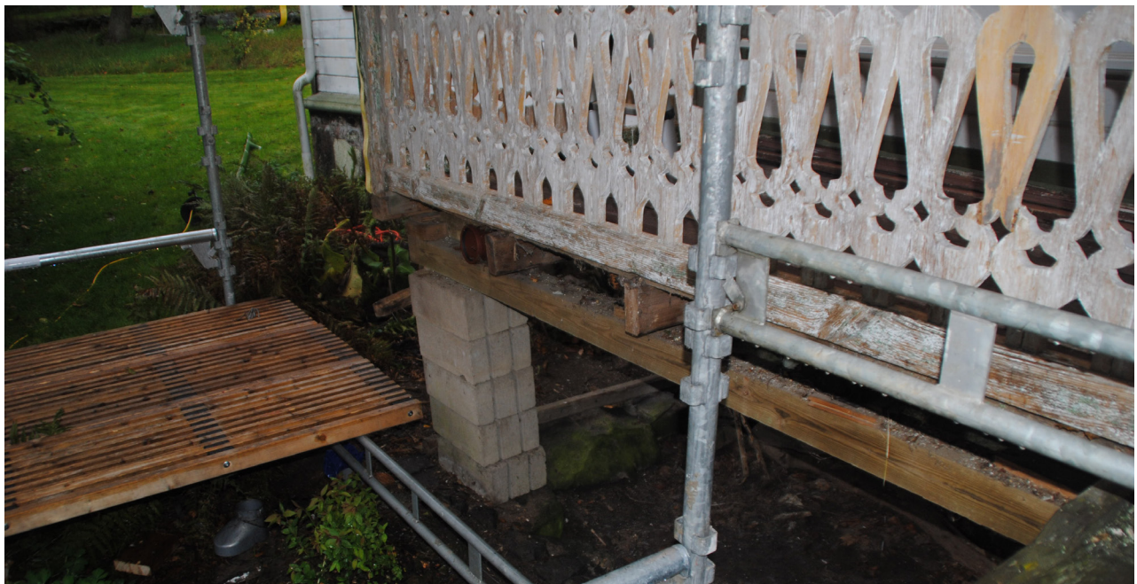
Listverket som gick runt nederdelen av verandan var rötskadat eller hade bytts ut mot en enkel bräda, troligen pga av tidigare rötskador. Hela listverket togs bort för byte mot nytillverkade lister.
