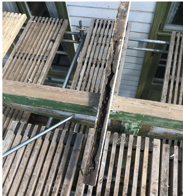
En av takbjälkarna var så rötskadad att den inte gick att spara. Två hade mindre skador som gick att laga.
